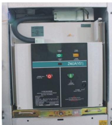
断路器抽出式部件在试验/隔离位置
