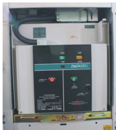
断路器隔室（门打开）断路器抽出式部件在运行位置
